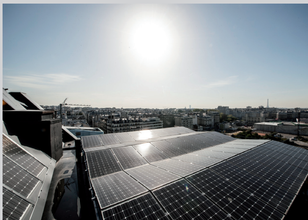
Toitures photovoltaïques du projet Clichy Batignolles (crédit photo : François Grunberg - Mairie de Paris)
