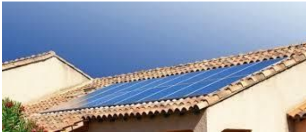
Exemple d'une installation de 6kWc
