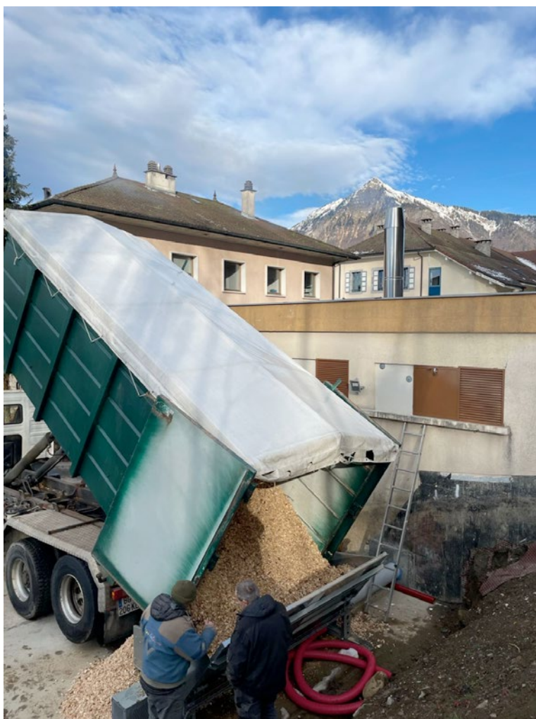
Un approvisionnement en plaquettes forestières en circuit ultra court à Chatillon-sur-Cluses en Haute-Savoie. Photo : ForestEner
