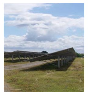
Parc photovoltaïque de Fontenay-le-Comte
