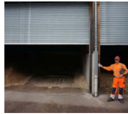
Hangar de stockage des plaquettes bois
