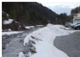
Muret de soutènement peu qualitatif, mais non visible depuis la route.
