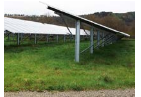
Surélévation des panneaux pour raison d'inondabilité
