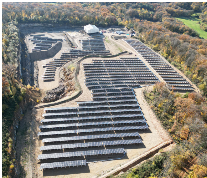
Centrale vue du ciel © Égrega
